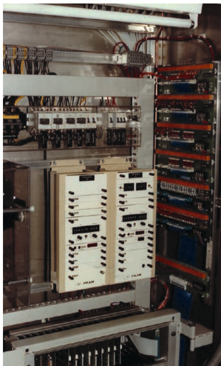
Steuerungskasten einer Anlage der Firma Jakob AG. Das war Hanspeters Berufsfeld.
