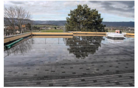
Sicht auf das Flachdach. Es fehlen noch die abschliessenden Spengler- und Dichtungsarbeiten.
